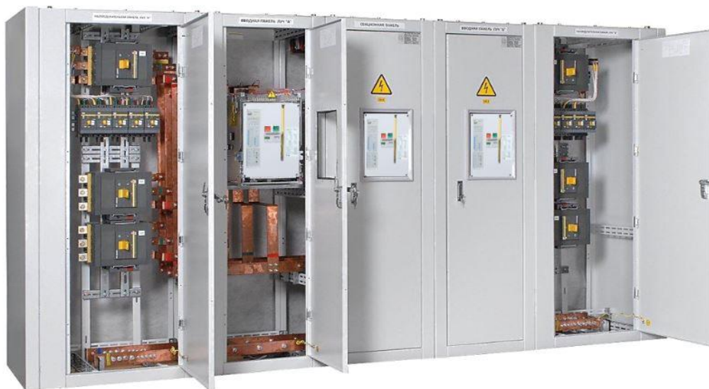
Рис. 2. Пример использования ВА07-М в главном распределительном щите.
