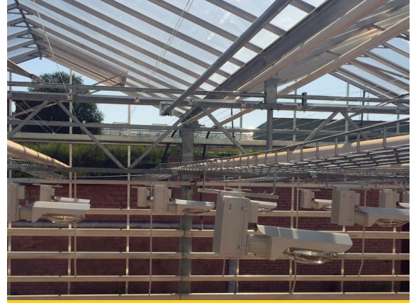
Система подвеса светильников на базе проволочных лотков
