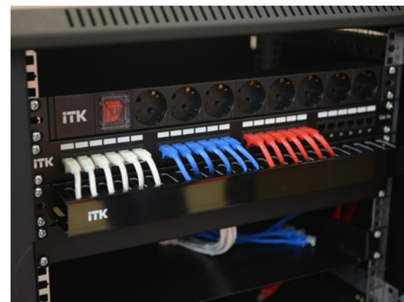
Настенный телекоммуникационный шкаф с оборудованием
