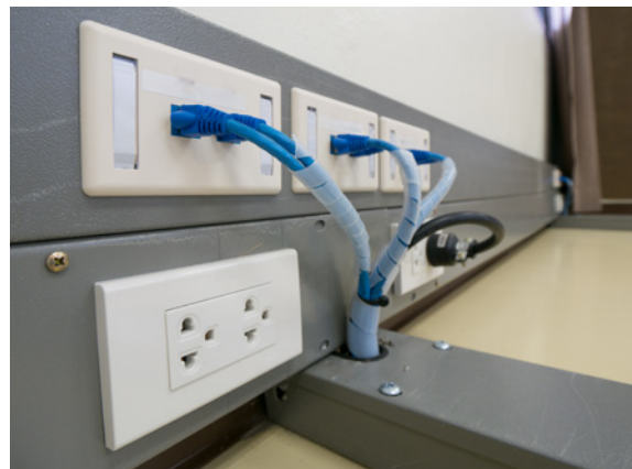
Информационные розетки с установкой в кабель-канал
