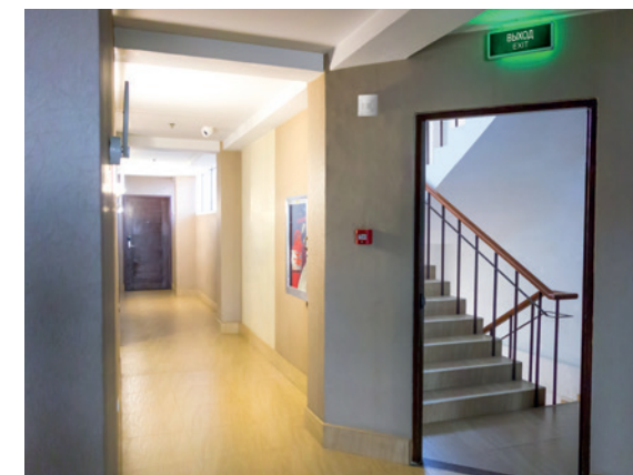
Лестница: аварийные светильники ДПА, датчики движения
