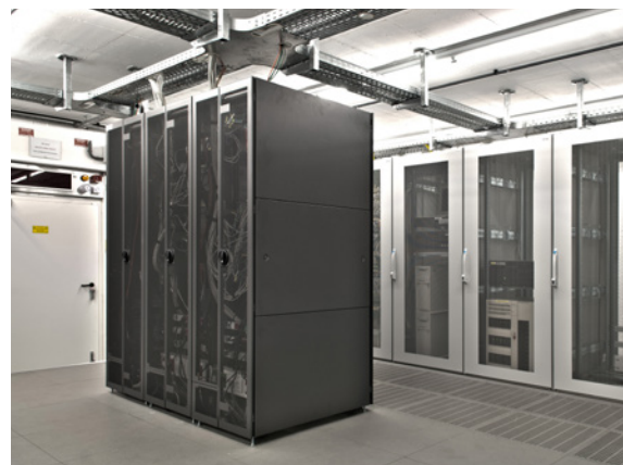
Серверные и уличные шкафы с системой мониторинга
