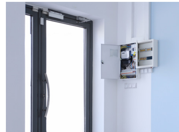
Щит этажный распределительный с кабель-каналом
