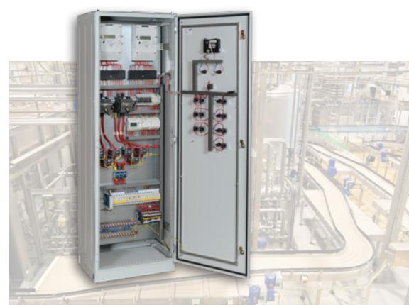
Вводно-распределительное устройство для ввода, учета и распределения электроэнергии
