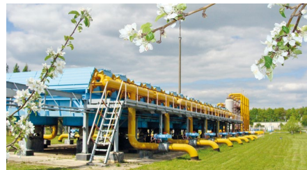
ООО «Газпром трансгаз Москва» «Тульское ЛПУМГ» Оснащение ИТСО и САЗ
